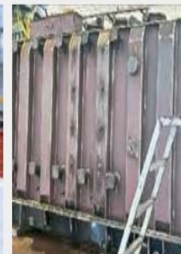
变压器油箱 Баки трансформаторов
