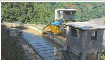
Мусороочистная машина для гидроэлектростанций (вид издалека)
